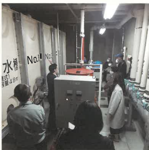
受水槽での説明の様子
